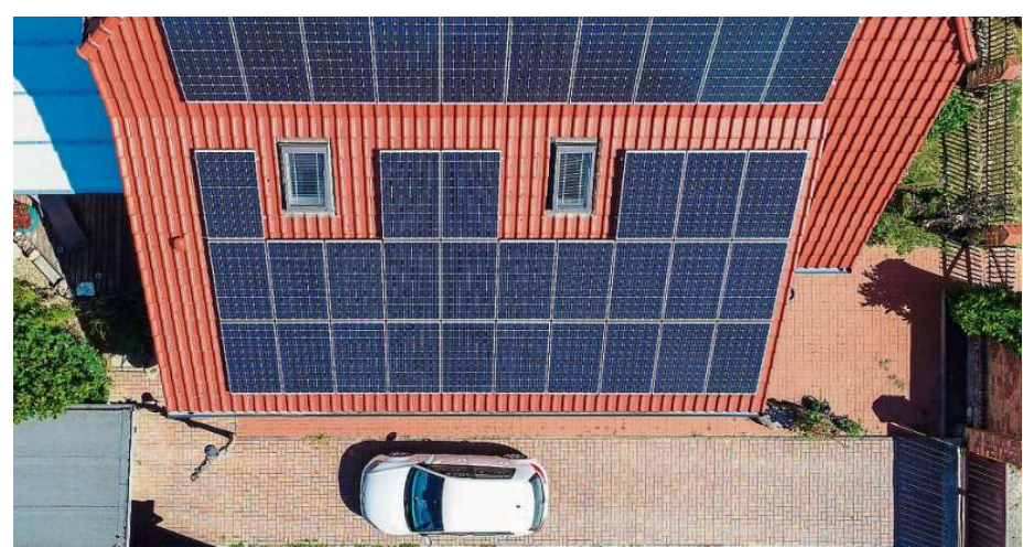
Sollten die Erträge der Solarkollektoren nach dem Winter niedriger sein, könnte das an möglichen Schäden der Solarthermieanlage liegen.
